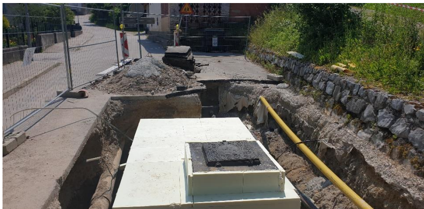
Vodovodni jašek s hidravličnim zadrževalnim ventilom
