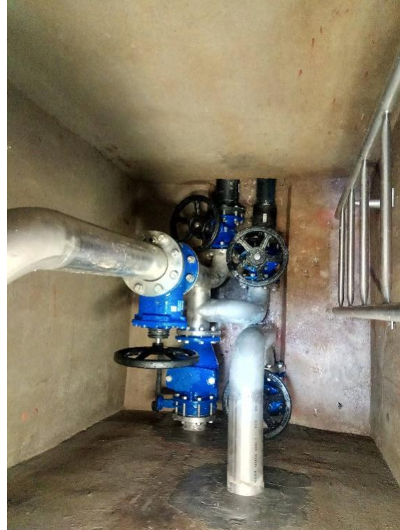
Obnovljena strojna oprema v VH Plešivica
