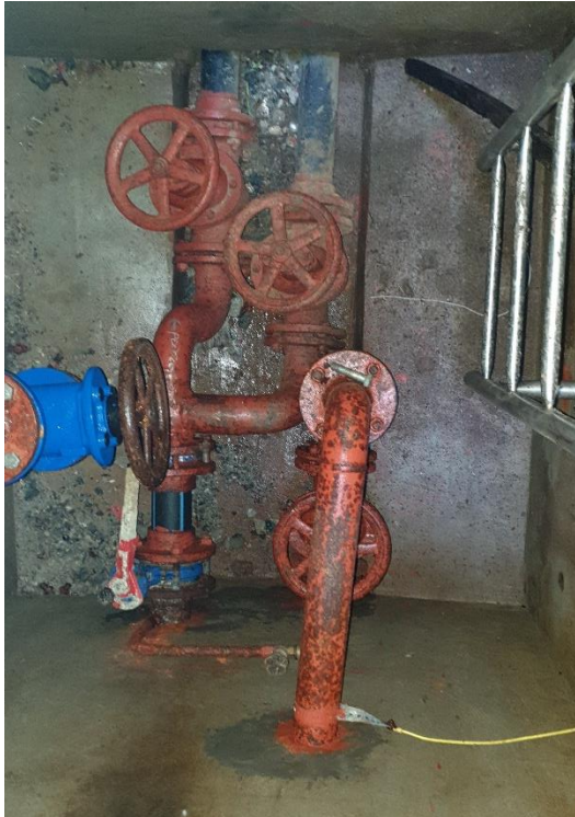
Strojne inštalacije v VH Plešivica
