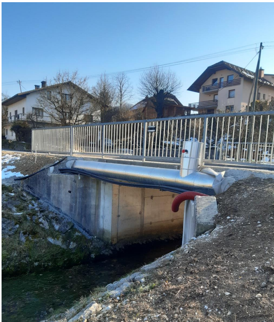
Konzolno obešen primarni vodovod z izolacijo
